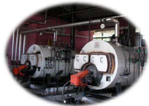
Figura 2. Generador de vapor pirotubular.
