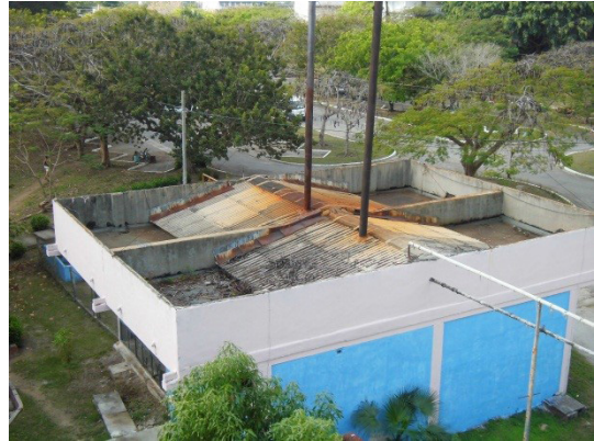
Figura 6. Vista superior de la Sala de Calderas de la UCF.
