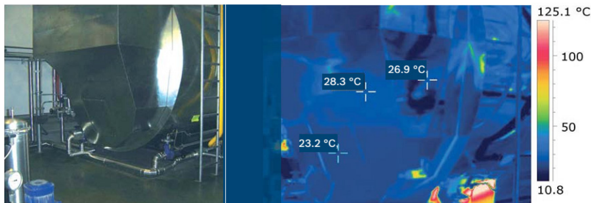
Figura 7. Vista posterior real y termográfica de una caldera con buen aislamiento térmico.
