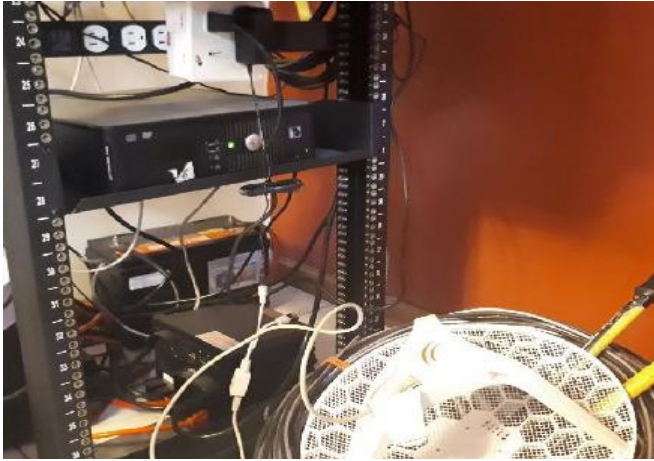
Figura 10. Nodo Router 1 Recopilando Datos.
