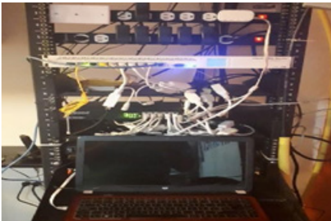
Figura 12. Nodo Coordinador y Servidor de telemetría.
